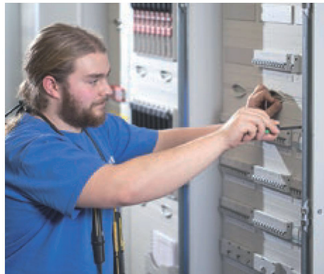
Jan Zimmermann vor einer selbst projektierten und gefertigten Hauptverteilung
